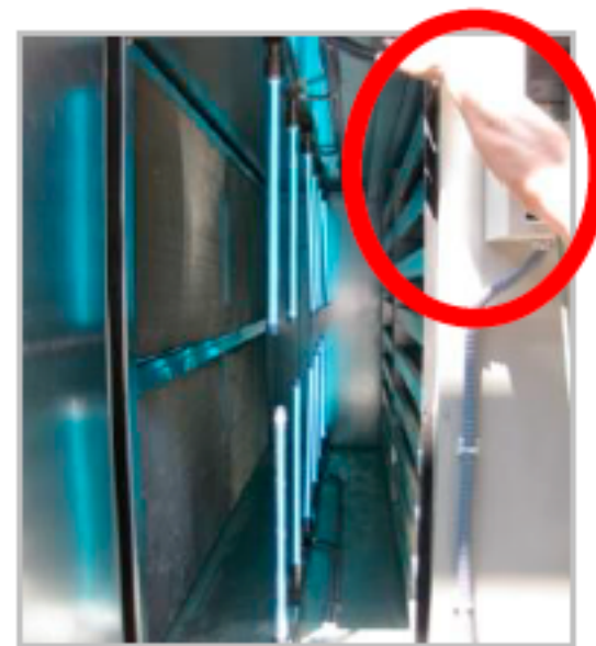
Figura 2: Lámparas UVC instaladas en UTA (Fuente: AIRE LIMPIO)
