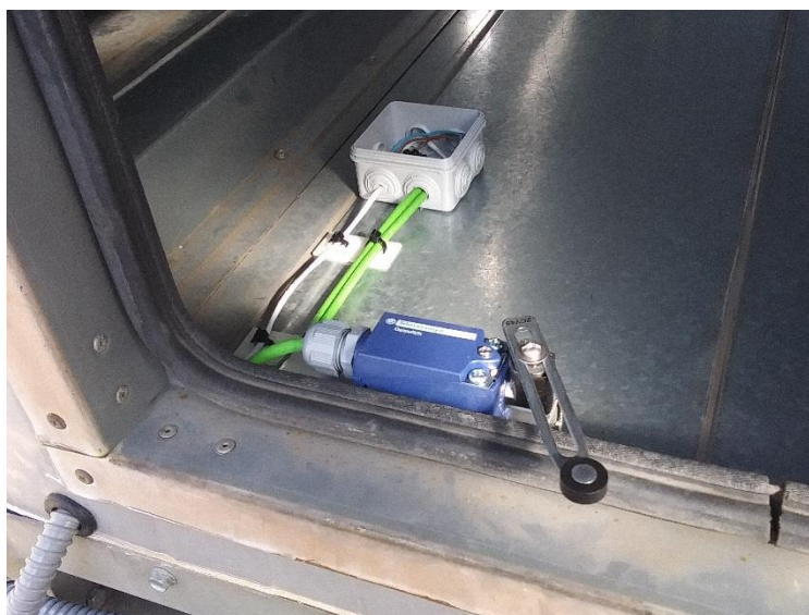
Caja de conexión e interruptor de puerta
